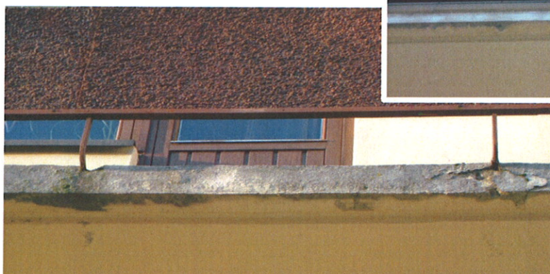
Skader rundt innfesting av rekkverk
