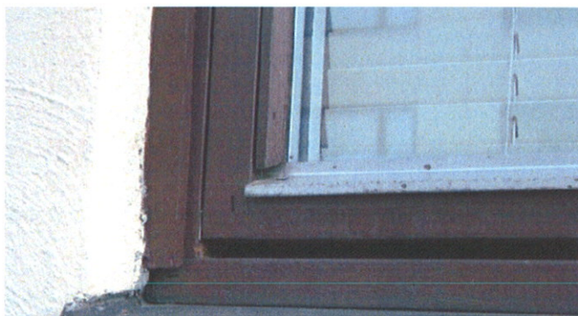
Vindu fra 1986 med noe malingslitt overflate
